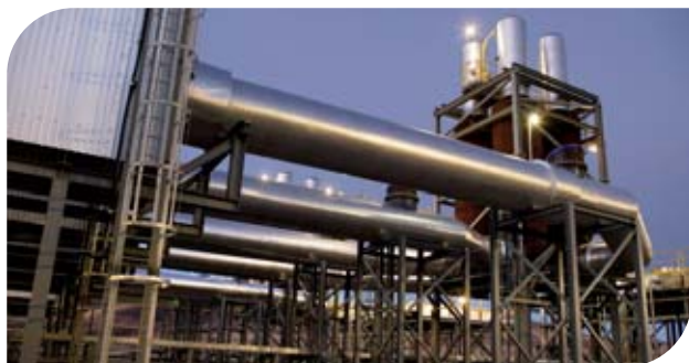
Wärtsilä har levererat ett gaskraftverk till Nevada, USA.
